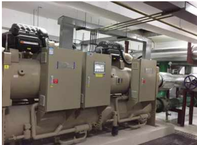
磁悬浮中央空调主机
